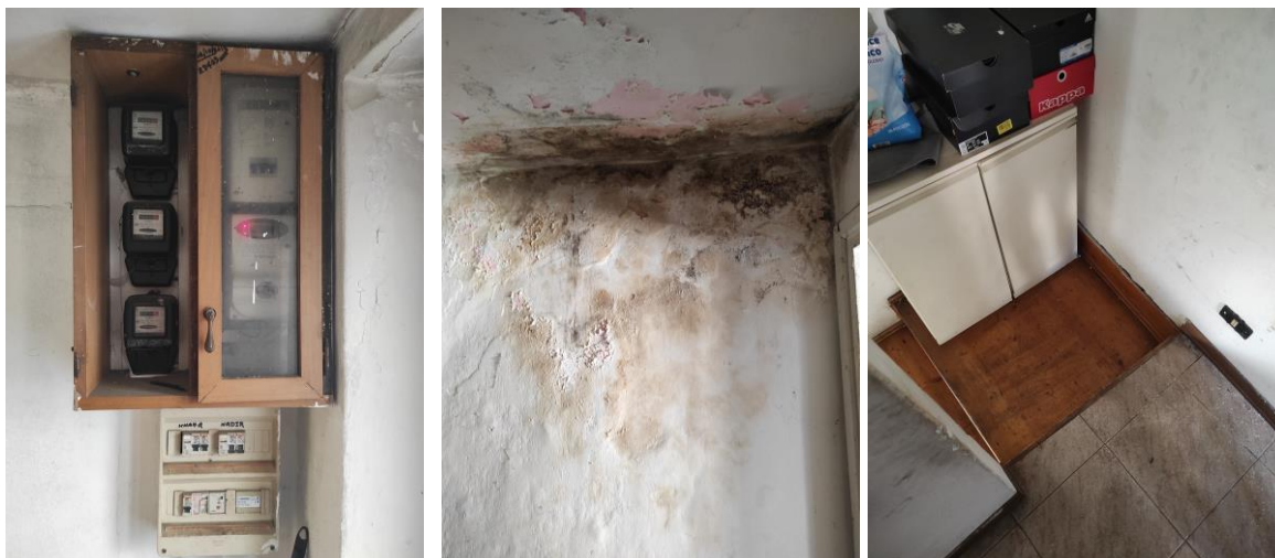
Contatori su Ingresso comune - Disimpegno comune (piano primo)
